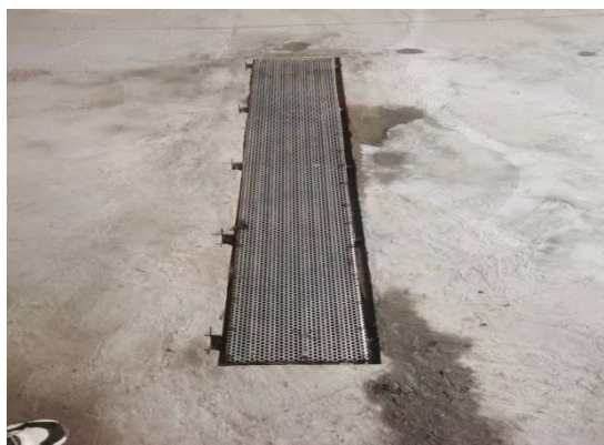
车间废水收集沟
