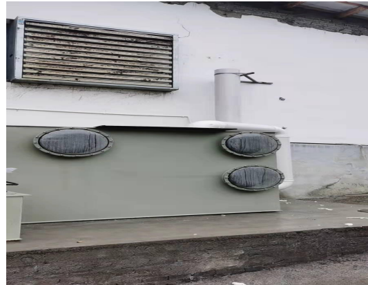
生物除臭设施
