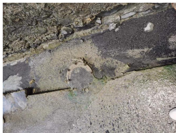
洗砂废水收集管道
