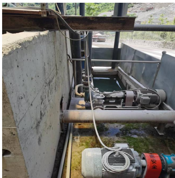
洗砂工序废水前处理池
