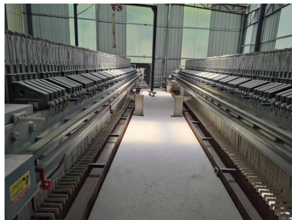
2 台板框压滤机
