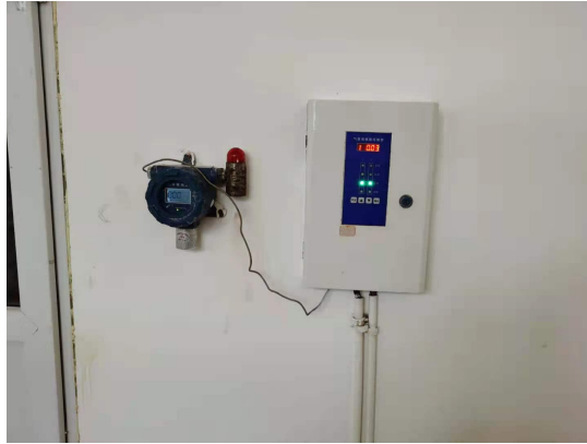
加药间气体监控报警系统
