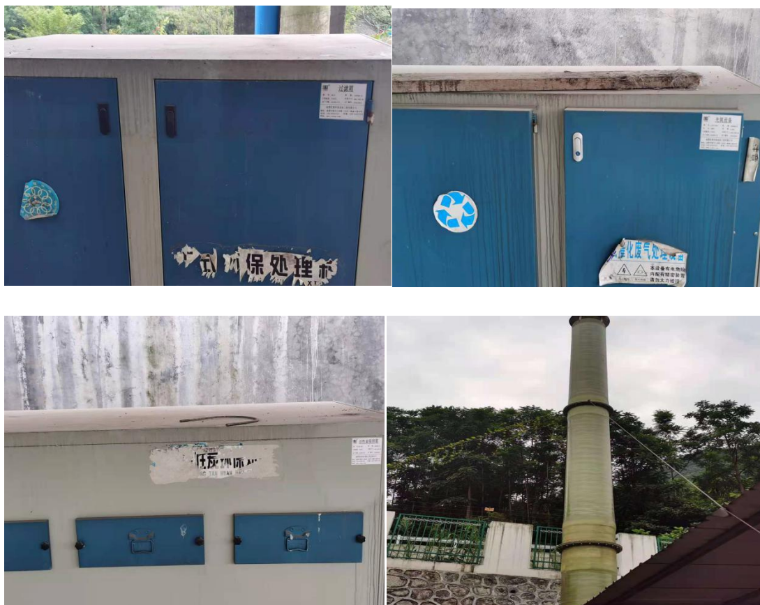
图 4-5 恶臭气体处理系统
