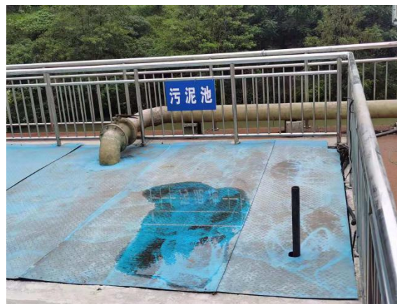
图 4-4 污泥池恶臭气体收集系统
