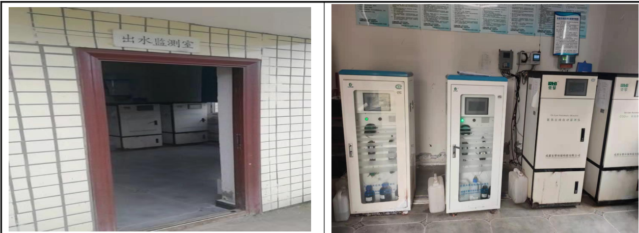
出水在线监测室及设备
