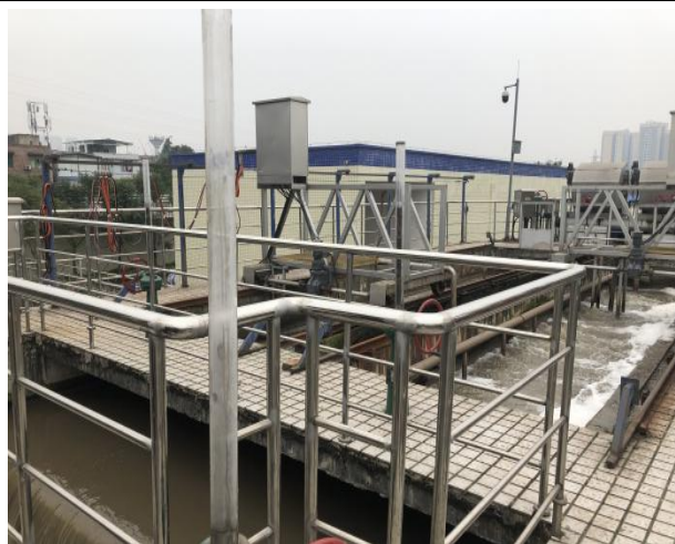
曝气沉砂反应池
